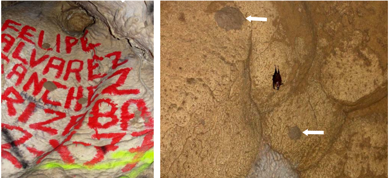
Fig. 4. Disturbio antropogénico en la Gruta de Atoyac (Atoyac, Veracruz, México): Graffiti, remoción de sedimentos y deterioro de la pared.
